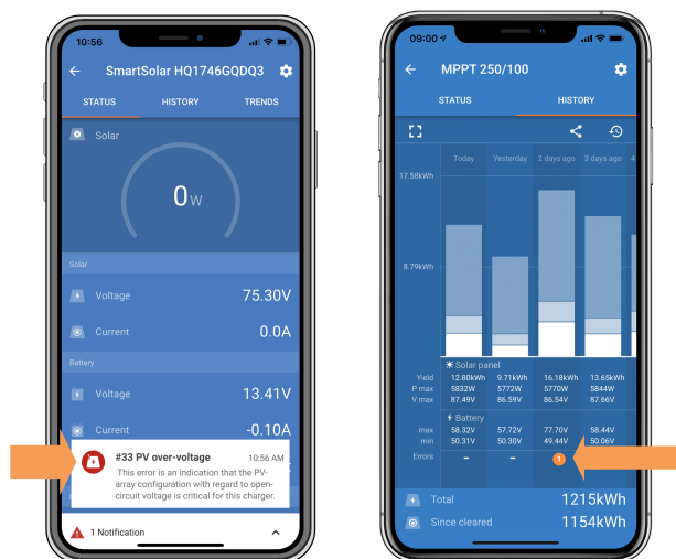
Eroarea nr. 33 a aplicației VictronConnect este afișată pe ecranul de stare și pe ecranul istoric.
